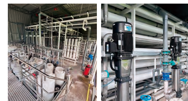
廃水処理に使用されるろ過設備
